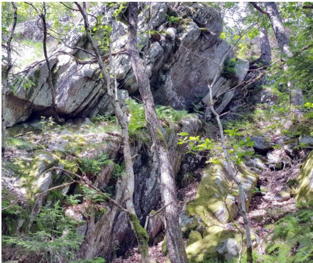
Figur 19: Et av flere steder der det er fare for blokknedfall fra naturlig terreng rett ved traséen. Bildet er tatt omtrent ved pel-nr. 950.
