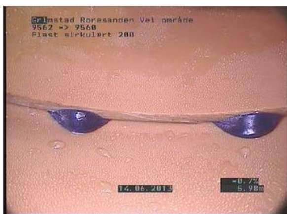
c) Synlig pakning observert ved rørinspeksjon
