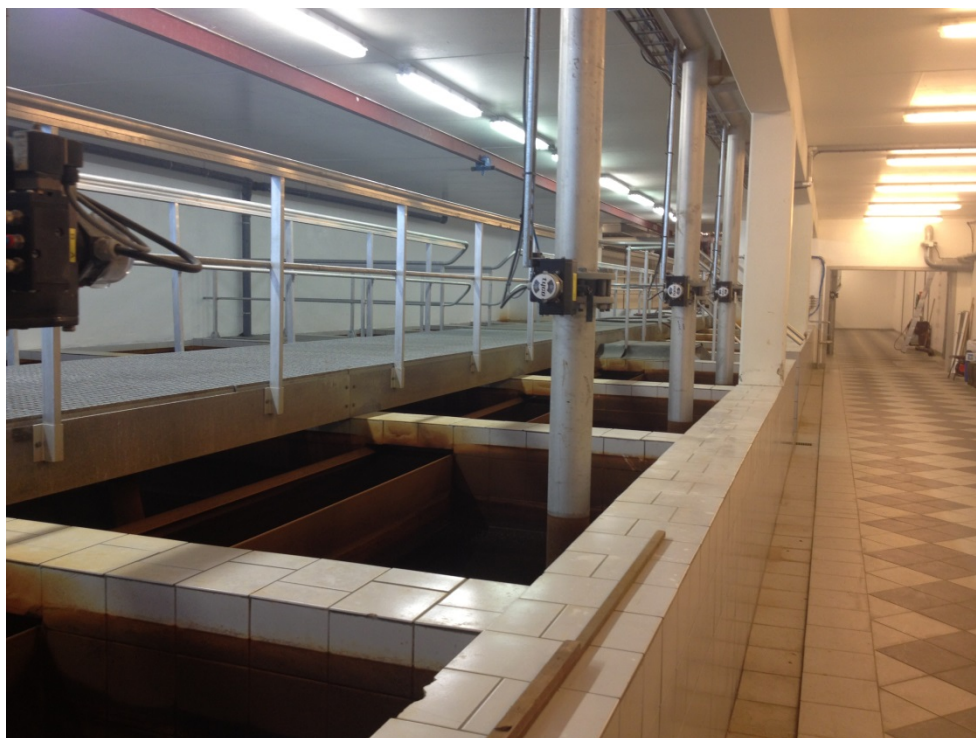
Figur 8.4. Filterbasseng ved Arendal vannbehandlingsanlegg (foto: SINTEF)
