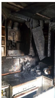
Bildet viser slukket brann i leilighet grunnet matlaging.
