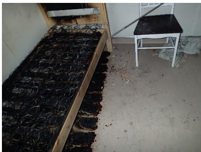
Bildet viser slukket brann i seng i kommunal bolig.
