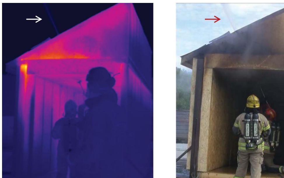
Figur 32: slokking fra korridor og opp i loftet. Strålen har vært for lenge på samme punkt og skjært seg gjennom tre OSB-plater. Mesteparten av vannet forsvinner ut i lufta [25].
